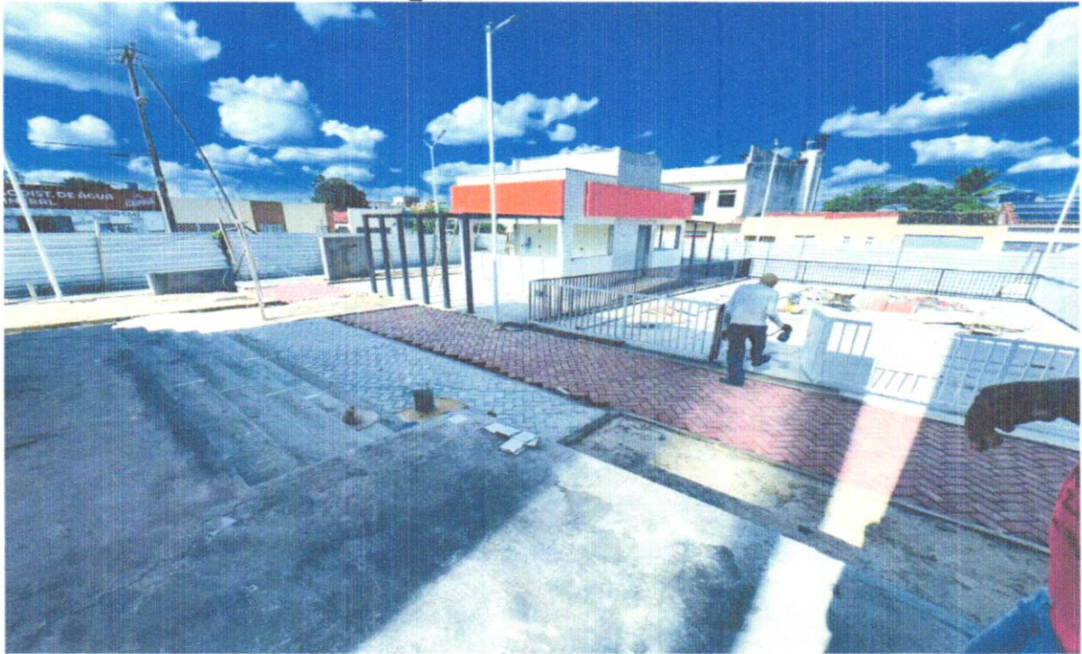
FOTO 45 - EXECUÇÃO DE PÁTIO/ESTACIONAMENTO EM PISO INTERTRAVADO, COM BLOCO RETANGULAR DE 20 X 10 CM, ESPESSURA 10 CM. AF_12/2015
